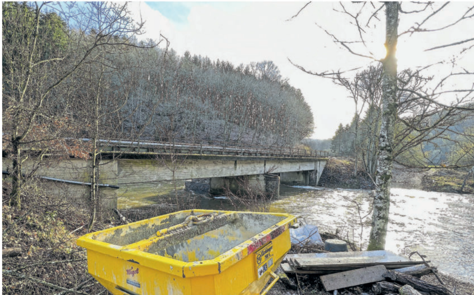
Die Sanierungsarbeiten an der Eisenbahnbrücke zwischen Gerolstein und Birresborn kann derzeit nicht fortgeführt werden. Der nicht standsichere Pfeiler ist bis zum Fundament vom Hochwasser 2021 unterspült worden und muss neu gesichert werden. Laut Angabe der bauausführenden Firma können die Arbeiten erst bei niedrigem Wasserstand weitergehen, weil der Bereich rund um den Pfeiler trockengelegt werden muss.
